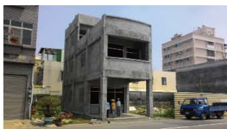
照片11 核准圖說未標示立面飾材者，應以粉刷、噴漿或塗料等方式完成外表修飾，且不得預留鋼筋、管路等
