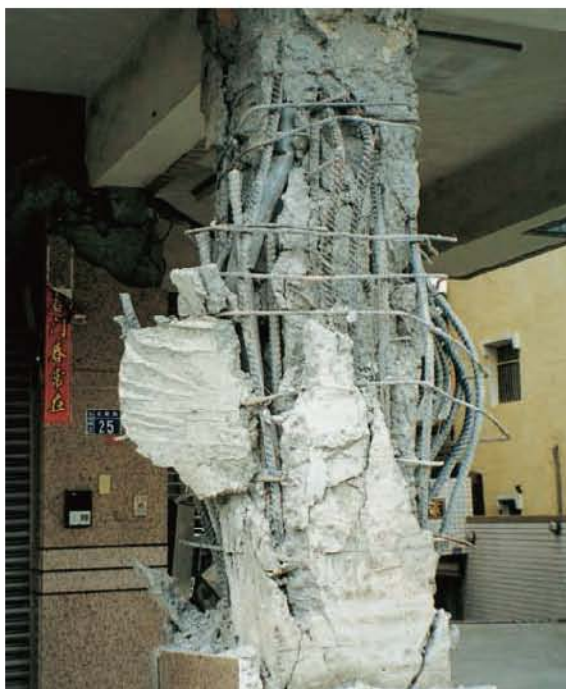
柱縱筋施工品質不良，造成破壞。
