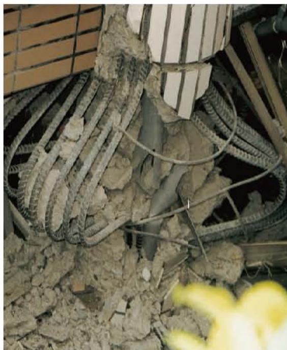
柱筋束束施工不良，造成主筋爆開成燈籠狀。
