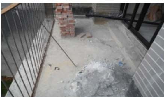
照片18 陽台欄杆不得以假材料假固定方式施作
