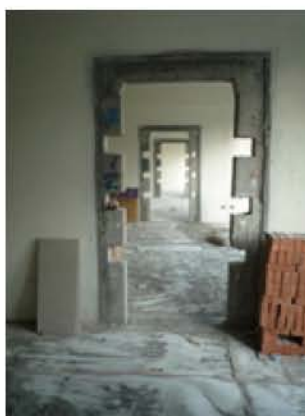
照片9 施工中工作口(狗洞)需依原設計圖材質封閉
