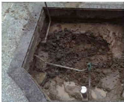
照片四：花台積水(土壤排水不良，黏性土質太多)
