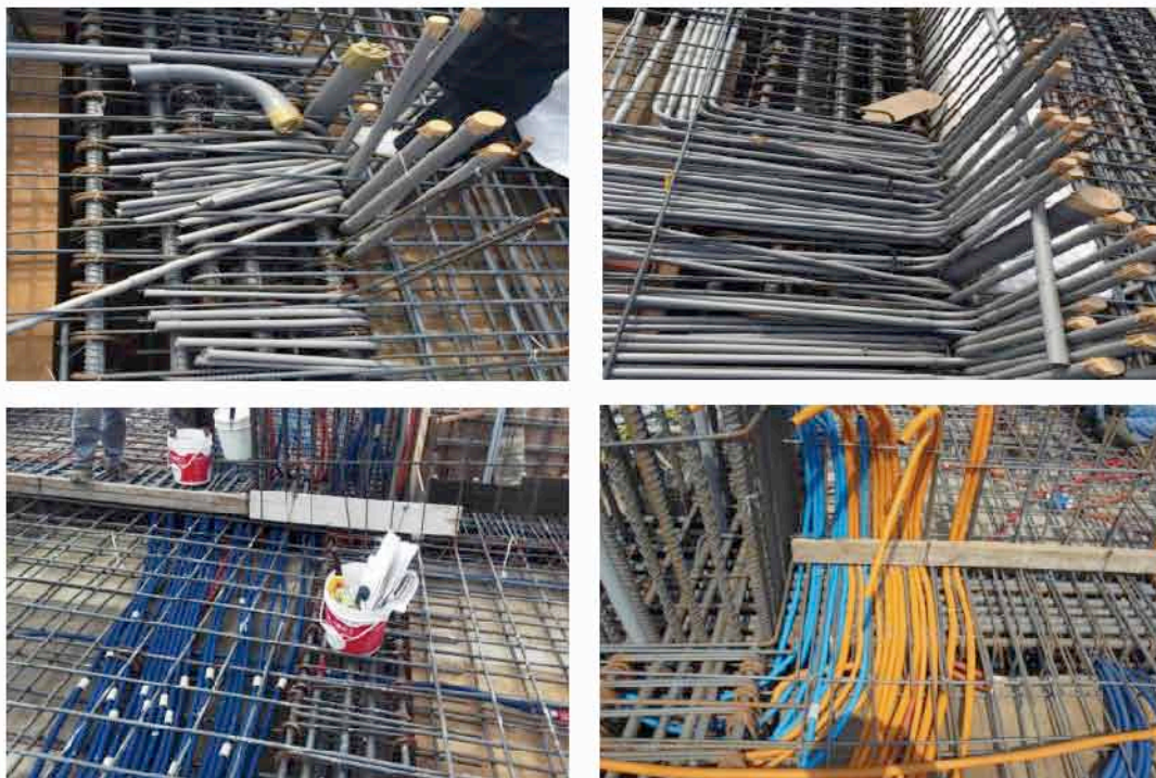
各戶電氣與弱電管路太多且埋設於RC結構內多集中同一處
