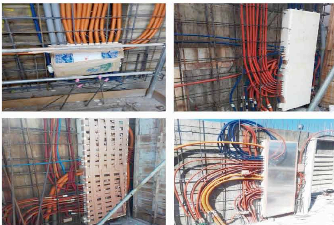
垂直面管路太多，影響RC牆結構
