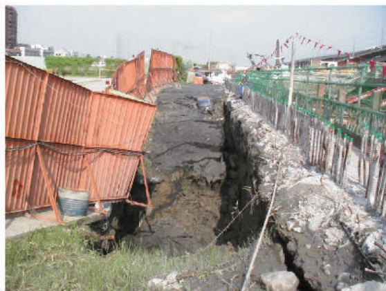
圖三 高雄某基地因基地內砂湧造成地表明顯沉陷
